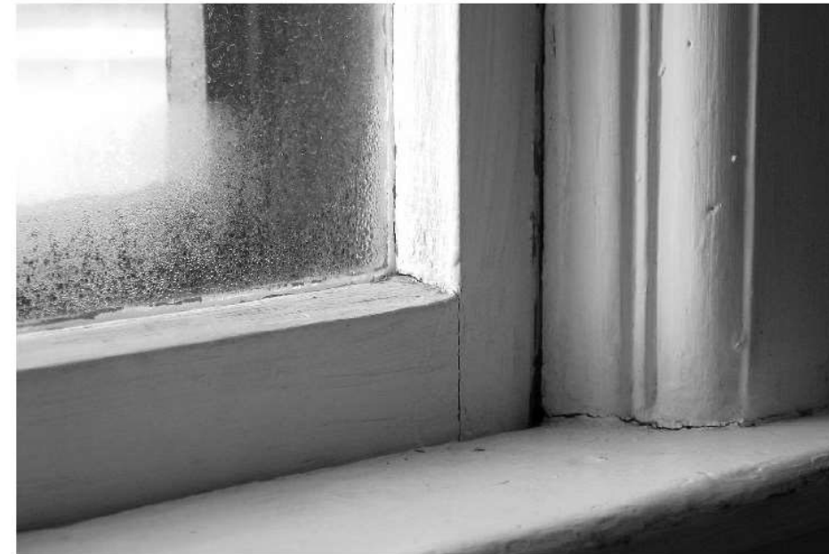
Abb. 26 Beschlagene Fenster sind oft ein Zeichen für eine schlechte Ventilation in Wohnräumen
